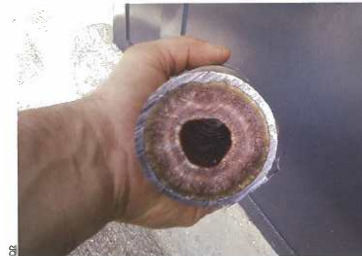
Avec des canalisations de 50 ans d'âge, les dépôts restreignent fortement le diamètre et rendent l'écoulement de l'eau parfois très difficile.
